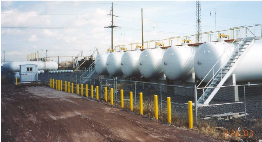
Imagen 3. Tanques horizontales o cilindros de GLP del tipo «salchicha».
